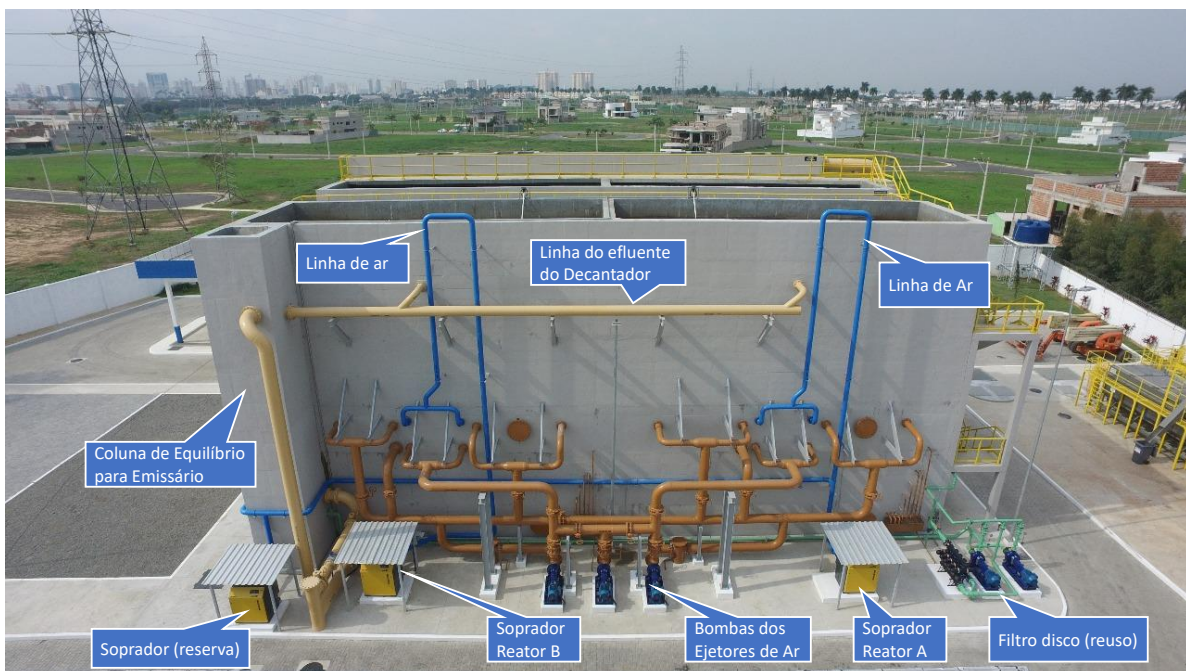
Figura 3 – Vista Frontal do Tratamento Secundário da ETE Esplanada
