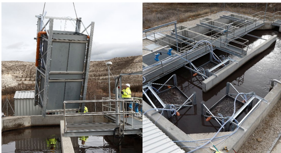
Figura 2: A torre com dois módulos de MABR sendo instaladas na vala de oxidação.
