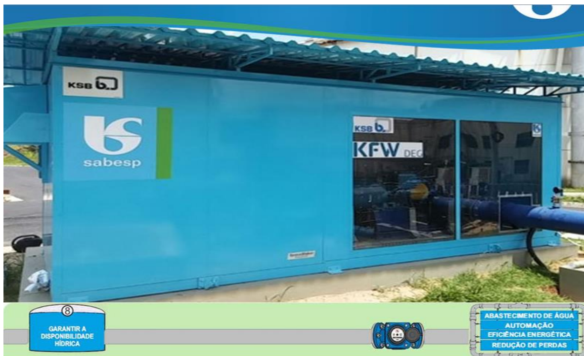
Figura 11: BFT passa a ser operada pelo Centro de Controle Operacional CCO) (fonte: Sabesp-2019)
