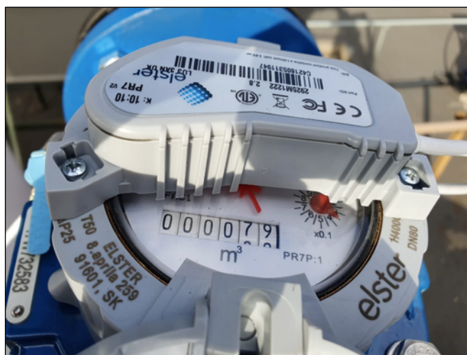
Figura 5: Hidrômetro com sensor digital para medição de fluxo da produção da estação de tratamento 2
