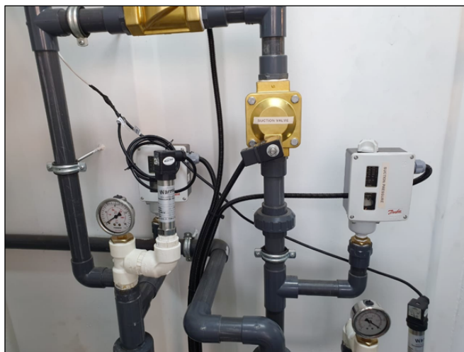
Figura 4: Sensores de pressão negativa e recalque instalados na estação de tratamento de efluentes 2
