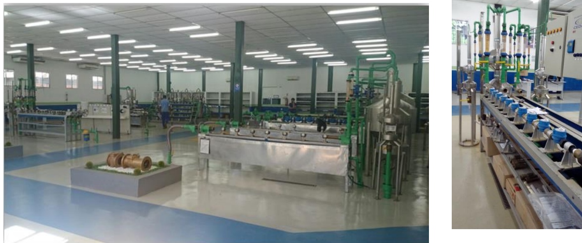
Figura 1: Instalações do Laboratório de Medidores da CEDAE-RJ e Bancada de Ensaio de IDM.
