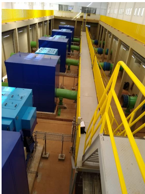
Figura 3 Estação de bombeamento de água tratada da ETA
