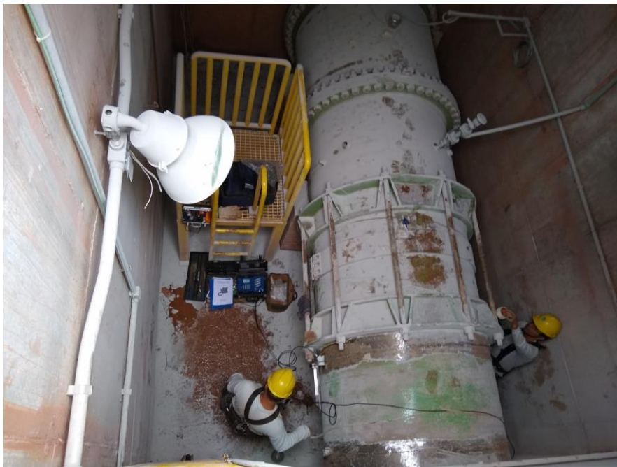
Figura 4 - Foto do ponto de medição da ETA onde fica o medidor eletromagnético de água tratada, bem defronte a escada amarela. Os técnicos da SABESP estão posicionando o medidor ultrassônico “clamp on” para as medições redundantes, nas duas pistas de onde foi retirada a tinta da tubulação.
