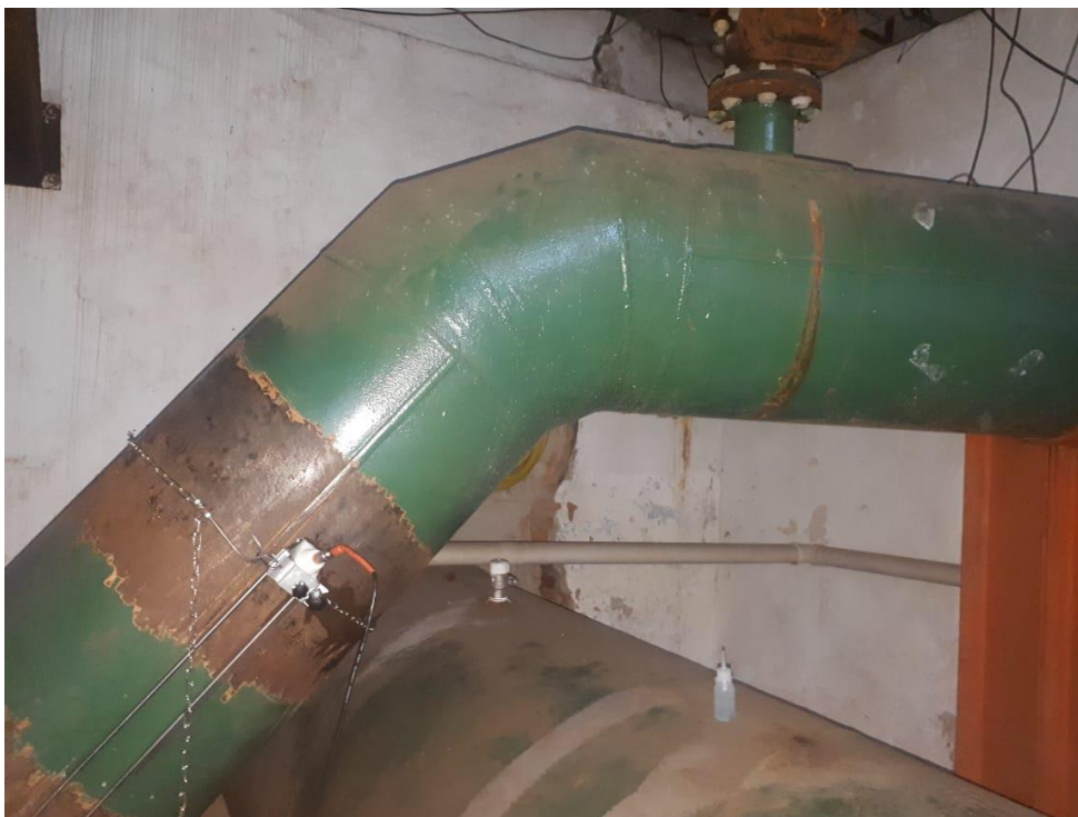
Fig. 4 – Medidor ultrassônico instalado.
