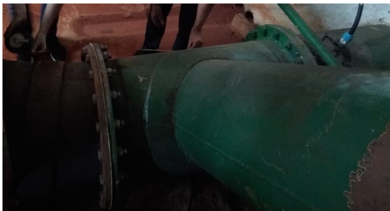
Fig. 5 – Conexão imediatamente a jusante do ponto de medição com o ultrassônico. Pode ser visto no canto inferior direito a superfície lixada, que é a pista onde foi instalado o medidor ultrassônico.
