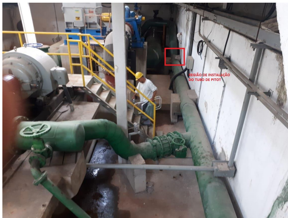
Fig. 2 – Tubulação de saída da 2ª bomba, conectando-se em “Y” com a tubulação onde estão instalados o Pitot (ressaltado em cor vermelha) e o medidor ultrassônico (tubulação inclinada, ao fundo). Deve ser observado que o escoamento entra na tubulação tronco após ser bombeado, passar por duas curvas, uma válvula e entrar via derivação em “Y”, bastante perturbado. Na figura é mostrada a saída de apenas uma das bombas, sendo que a outra está a 5 metros desta, em paralelo
