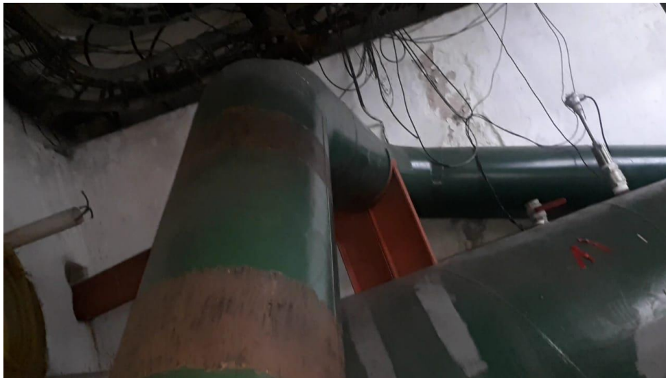
Fig. 3 – Local de instalação do medidor ultrassônico. O escoamento vem de diversas singularidades a montante, mostradas na figura anterior, e passa por mais três curvas a jusante do Pitot.
