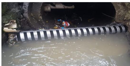
Figura 10 – Foto da Calha Coletora de Esgoto
