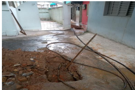
Figura 8 – Rede de esgoto
