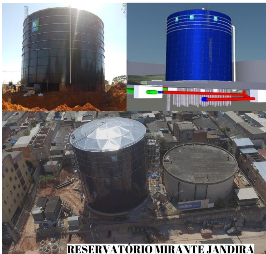
Figura 19: Comparativo de um Reservatório Executado versus o projetado.
