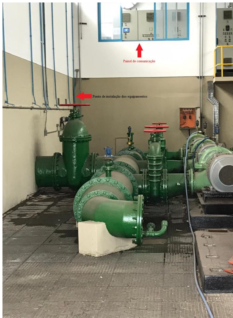
Figura 3: Casa de bombas do CRAT - Ermelino
