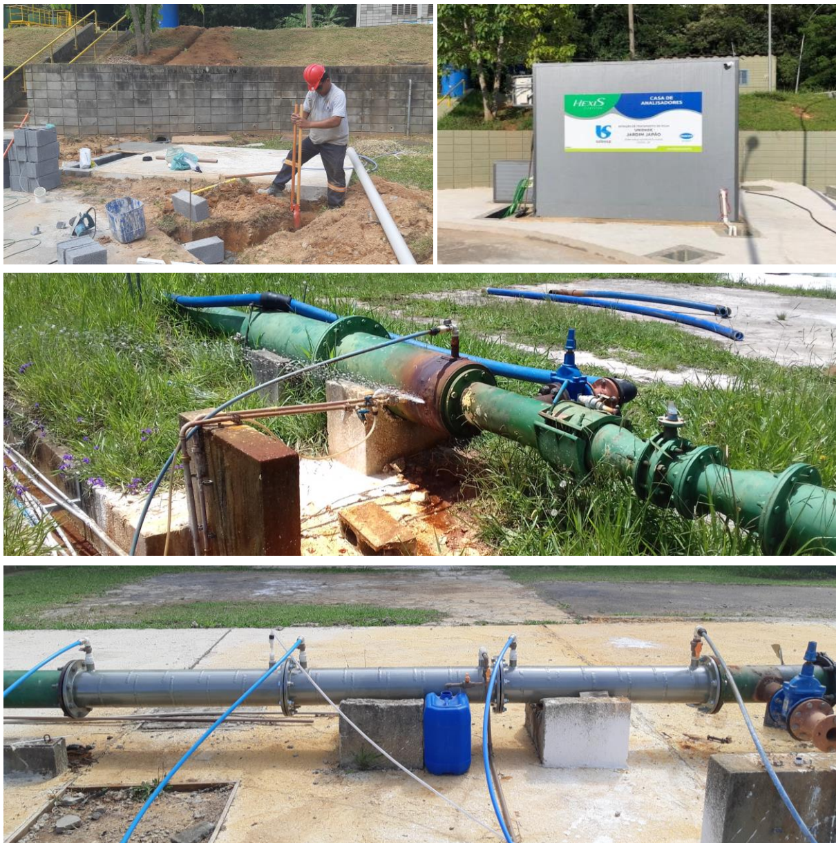
Figura 3: Casa de analisadores instalado na ETA Jd° Japão e instalação dos misturadores hidráulicos em série. Fonte: Acervo pessoal.
