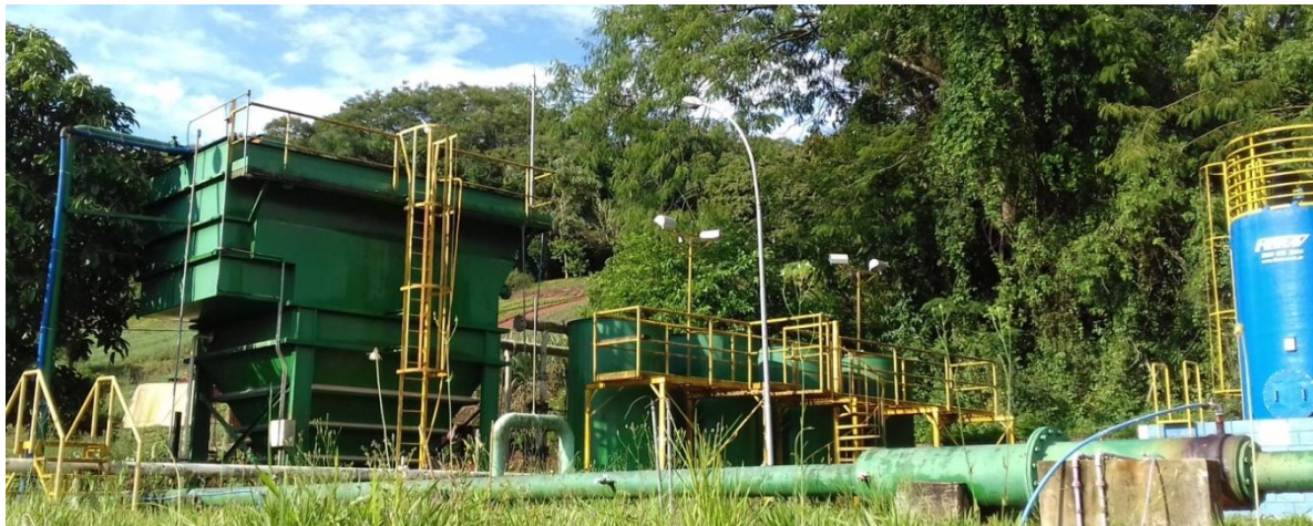
Figura 2: Vista parcial da ETA Jardim Japão. Fonte: Acervo pessoal
