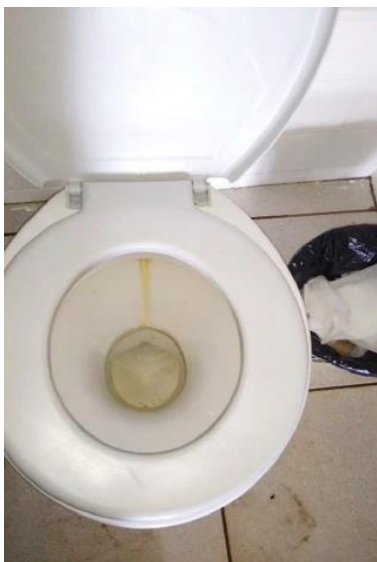
Figura 8: Válvula hidra travada
