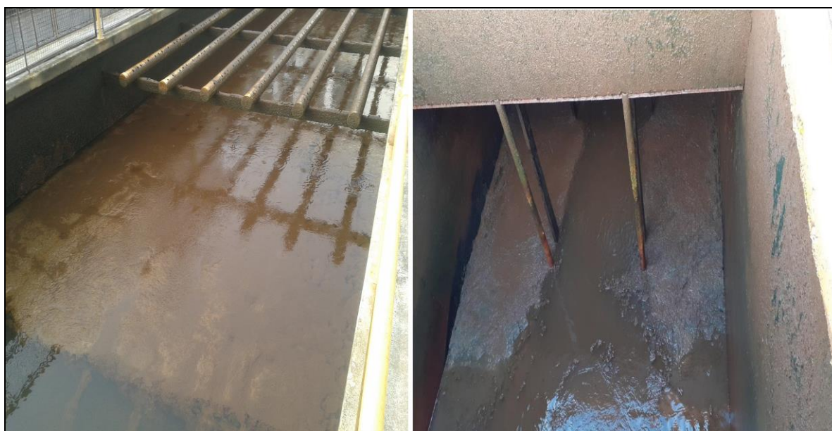
Figura 04: unidade de decantação em processo de descarga na ETA em Guaratinguetá. Fonte: própria (2021).
