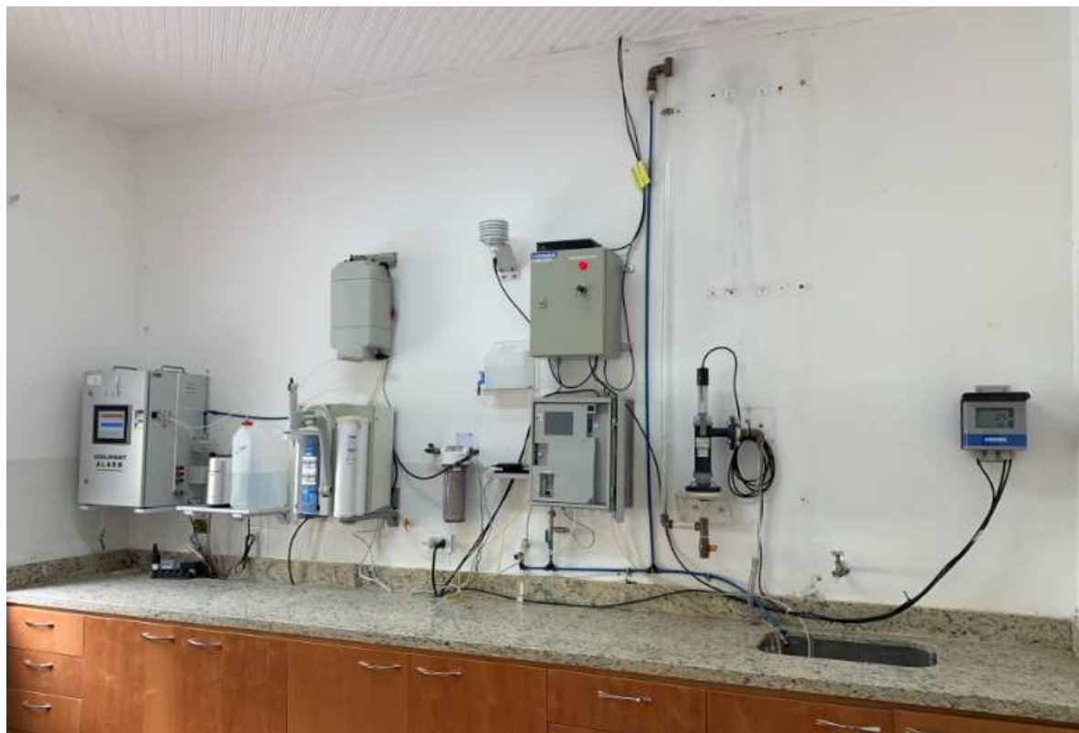
Figura 3 – Equipamentos de medição físico-químico e microbiológicos on line instalados
