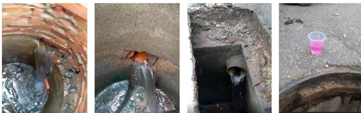
Figura 1: Exemplos de Vazamentos em Poços de Visita e Galerias de Águas Pluviais e Amostra com a Pastilha Reagente ao Cloro
