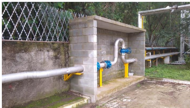
Figura 3: Cavalete DN 150 em aço inoxidável – Instituto Butantã (vista lateral).
