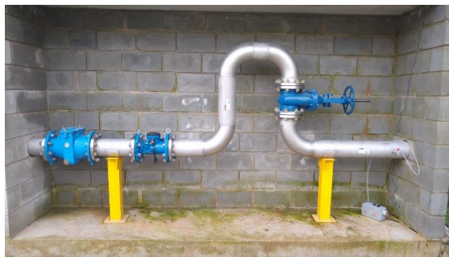
Figura 4: Cavalete DN 150 em aço inoxidável – Instituto Butantã (vista frontal).
