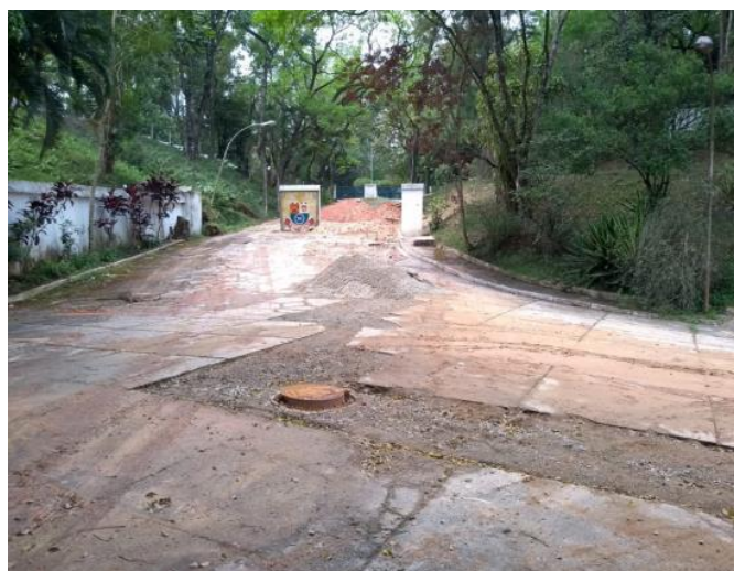
Figura 4: Implantação da rede de esgoto no pátio interno do Complexo Barro Branco prédio 3
