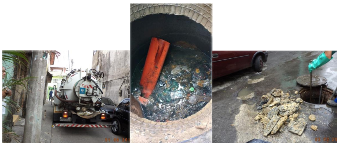
Figura 17 - Locais de difícil acesso e redes com muita sujeira e excesso de gordura
