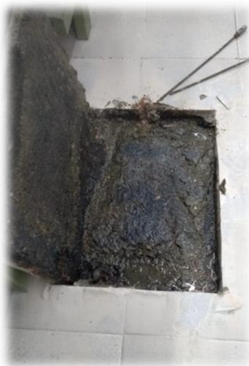
Figura 3 - Caixa de inspeção cheia
