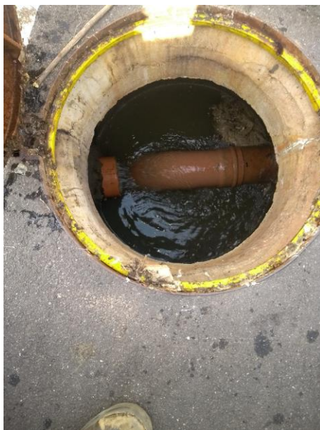
Figura 5 PV de Decantação com Curva para Retenção
