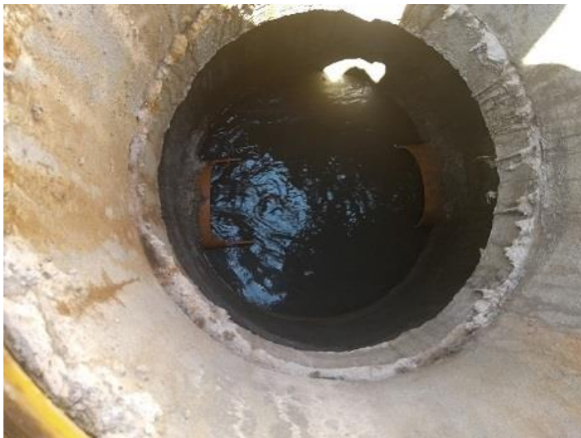
Figura 7 PV de Decantação
