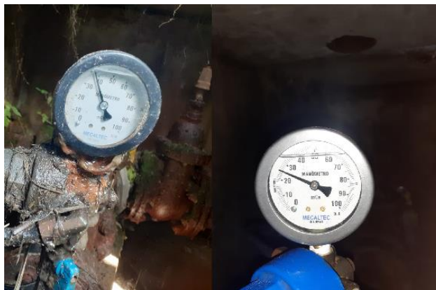
Figura 4 - VRP Enseada antes (à esquerda) e depois (à direita) dos ajustes. Ponto crítico R. Austria, nº 70 com 15 mca. Fonte: SABESP.
