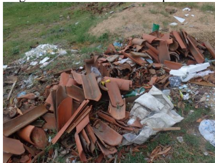
Figura 7. Resíduos de telhas quebradas.
