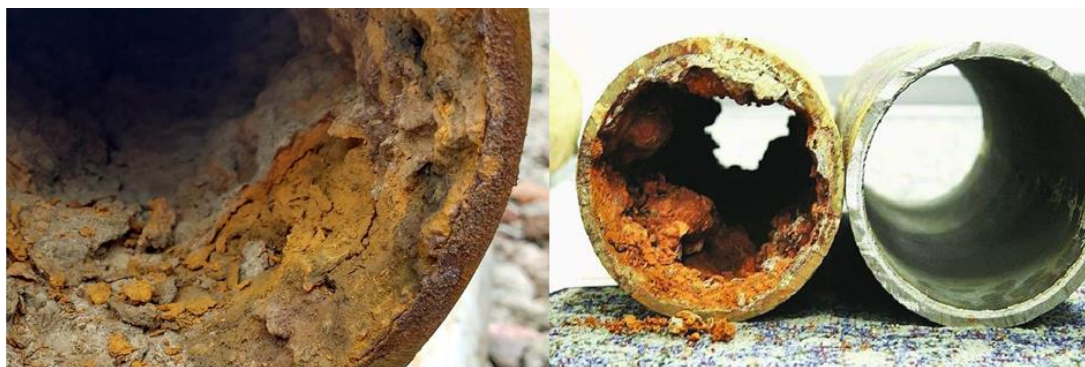
Figura 4: Processo de incrustação na parede interna de dutos de ferro fundido.
