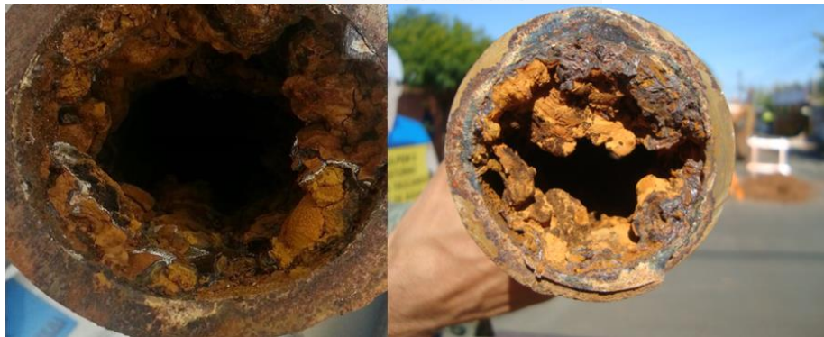
Figura 10: Encrustação nas tubulações de Ferro Fundido.
