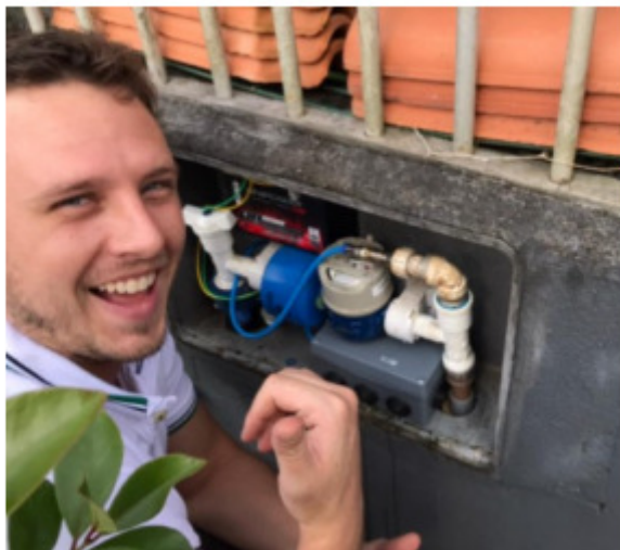
Foto 1 – Sensor IoT (.HYD) instalado na Caixa Padrão do ponto Crítico para Monitoramento do Step test (Companhia Águas de Joinville, 2021)
