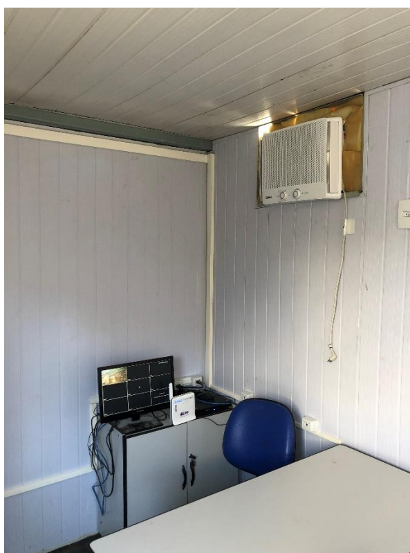
Figura 6 - Sistema de vigilância e ar condicionado
