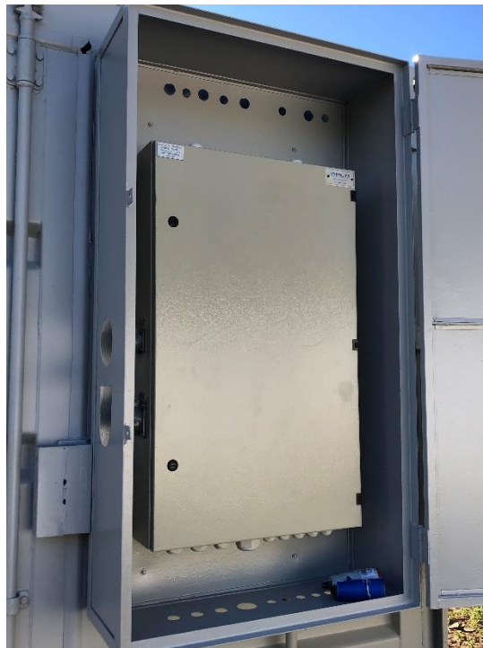
Figura 4 - Quadro de comutação
