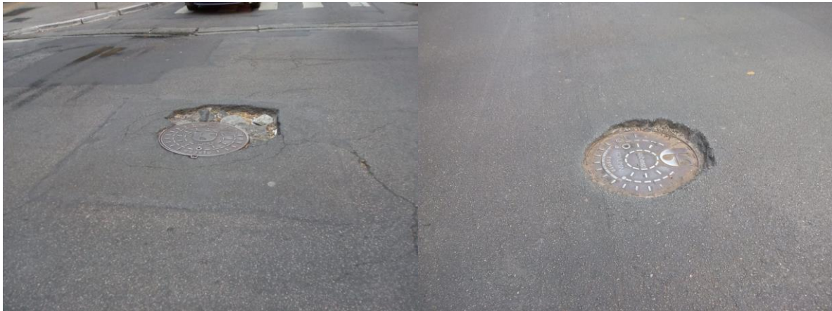
Imagem 4 e 5: Poços de Visita desnivelados
