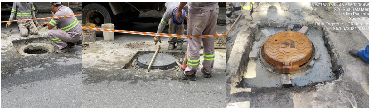
Imagens 6, 7 e 8: Aplicação do Micro Concreto de Cura Rápida em nivelamento de PV
