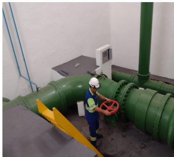
Figura 20: Manobra – abertura e/ou fechamento de reservatório
