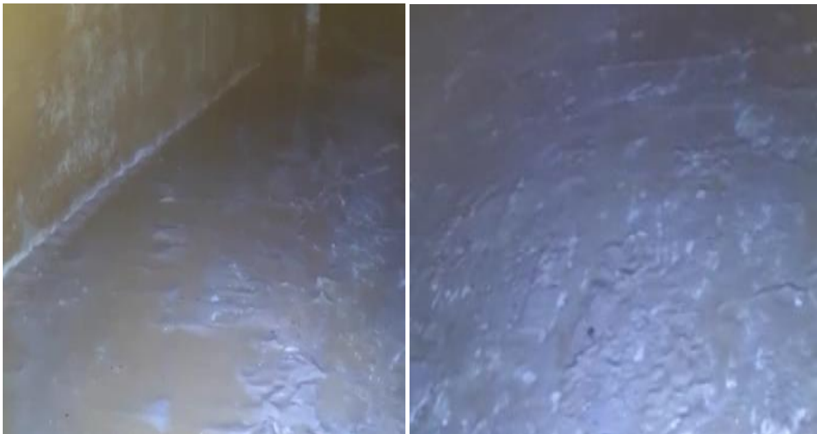
Figura 10 e 11: Imagem de lodo depositado no fundo do reservatório
