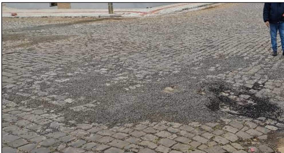
Figura 11 - Localização de reparo recente na esquina da R. Frei Justino Girardi com a R. Cel. Ferminiano R de Almeida, decorrente de vazamento visível de água.
