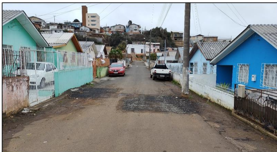
Figura 9 - Localização de reparo recente na R. Castro Alves, decorrente de vazamento em ramal.
