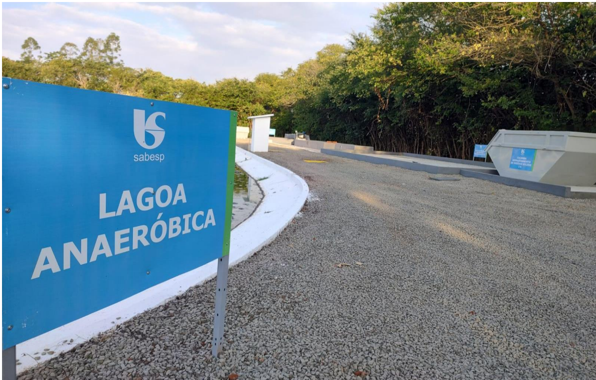
Figura 6: Placa de identificação para a lagoa anaeróbica.
