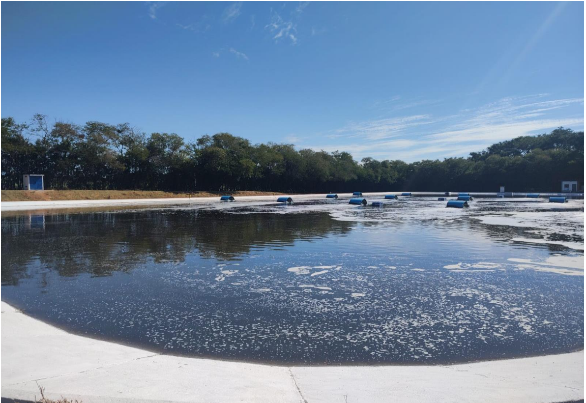
Figura 9: Lagoa facultativa com 14 aeradores em funcionamento.
