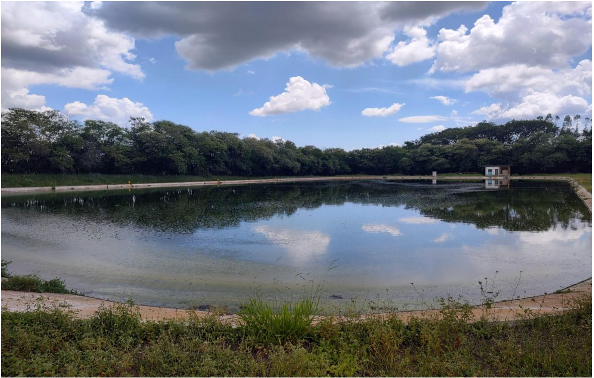
Figura 8: Lagoa facultativa antes da instalação dos aeradores e revitalização da área.
