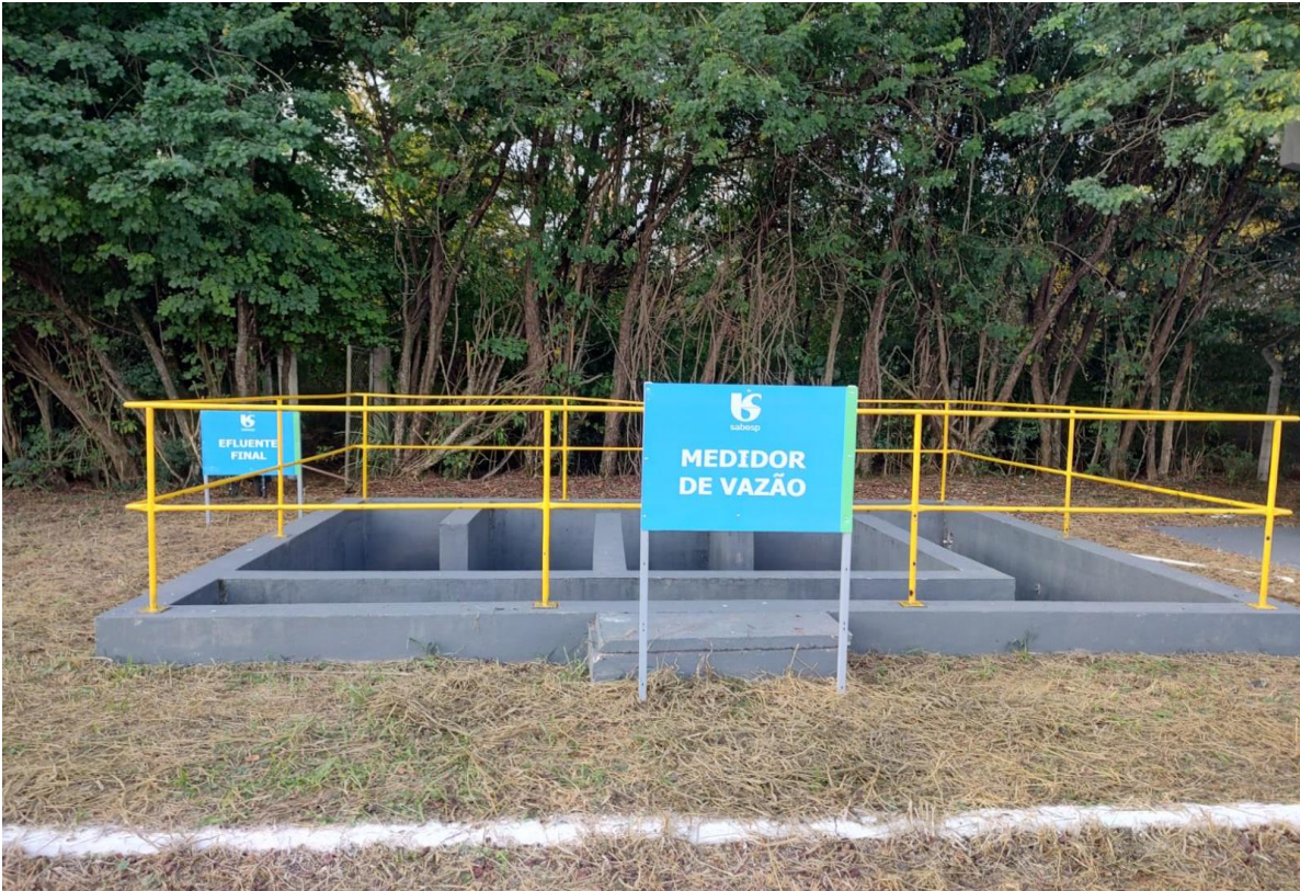
Figura 12: Identificação do medidor de vazão e efluente final.
