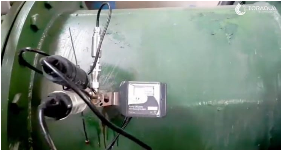
Figura 2 - Vista do equipamento de medição termodinâmica de rendimento da bomba composto por monitor da bomba, transdutor de temperatura e transdutor de pressão.
