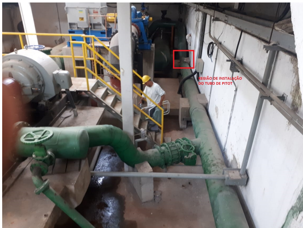
Fig. 1 – Tubulação de saída da 2ª bomba, conectando-se em “Y” com a tubulação onde estão instalados o Pitot (ressaltado em cor vermelha) e o medidor ultrassônico (tubulação inclinada, ao fundo). Deve ser observado que o escoamento entra na tubulação tronco após ser bombeado, passar por duas curvas, uma válvula e entrar via derivação em “Y”, bastante perturbado. Na figura é mostrada a saída de apenas uma das bombas, sendo que a outra está a 5 metros desta, em paralelo
