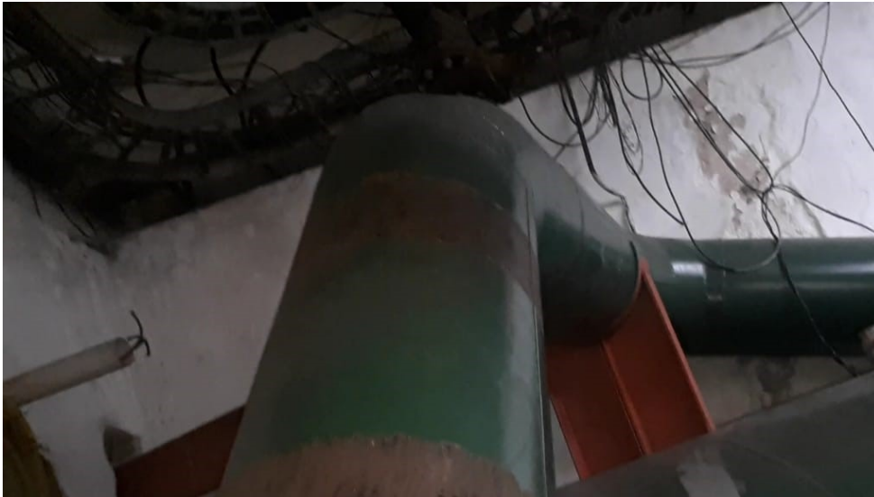
Fig. 2 – Local de instalação do medidor ultrassônico. O escoamento vem de diversas singularidades a montante, mostradas na figura anterior, e passa por mais três curvas a jusante do Pitot.
