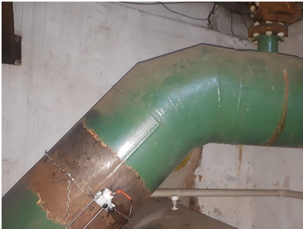
Fig. 3 – Medidor ultrassônico instalado.
