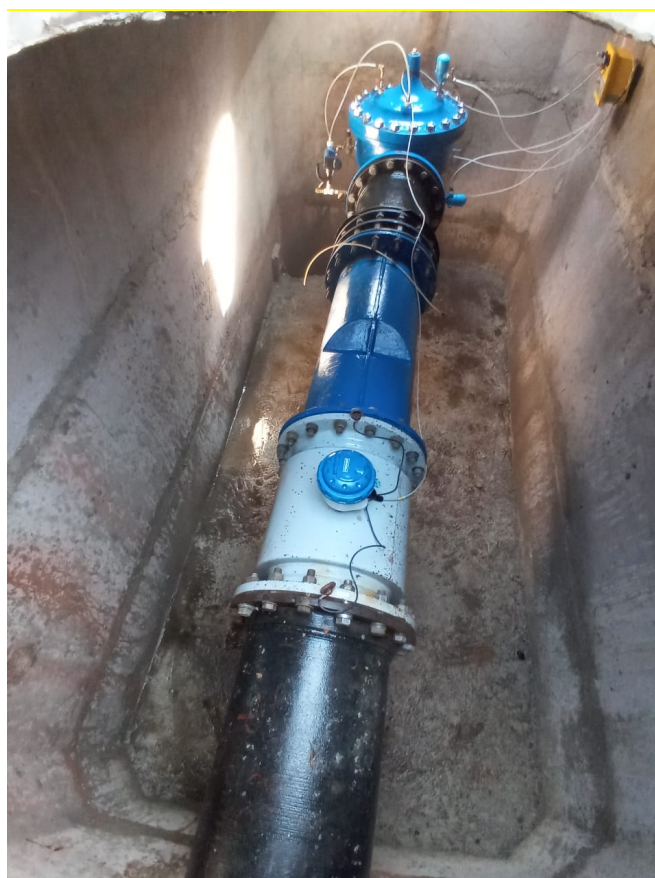
Figura 02 – Registro fotográfico da VRP Paulo Guilguer – instalação dotada de sensores de monitoramento, controlador, VRP e macromedidor
