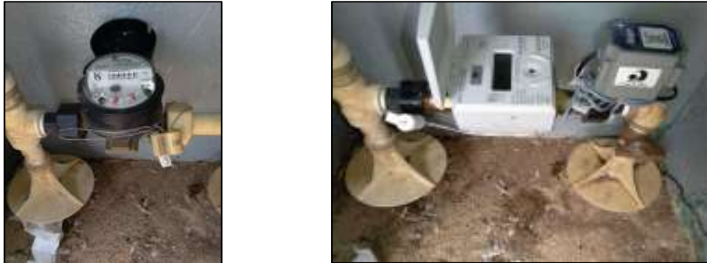
Figura 6 – hidrômetro convencional que foi substituído por ultrassônico e dispositivo IoT
