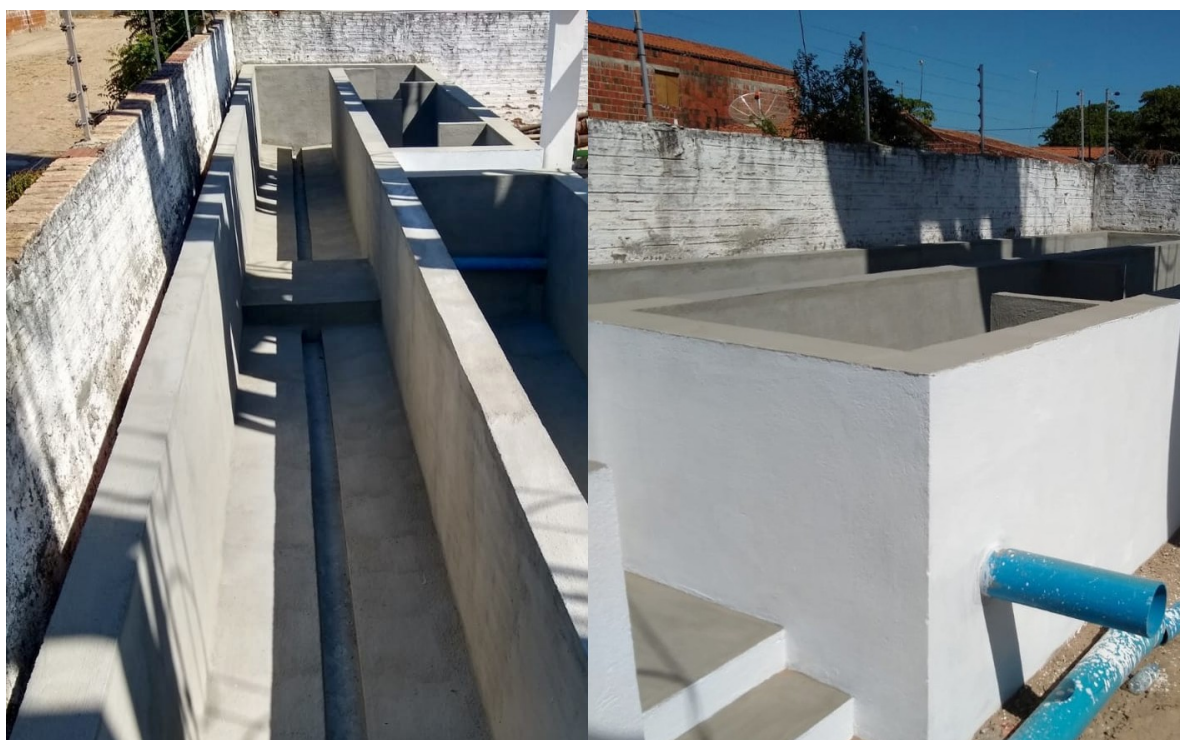
Figuras 7 e 8: Vista superior (à esquerda) e frontal (à direita) dos tanques de sedimentação na ETA Triângulo. Fonte: CAGECE (2022) adaptado.
