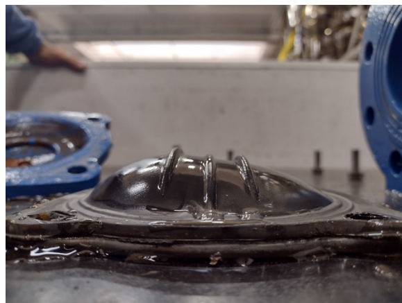
Figura 6 - Detalhe do abaulamento do diafragma da VRP (Fonte: Autor)
