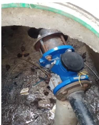
Figura 4 - Medidor ultrassônico já existente (Fonte: Autor)
