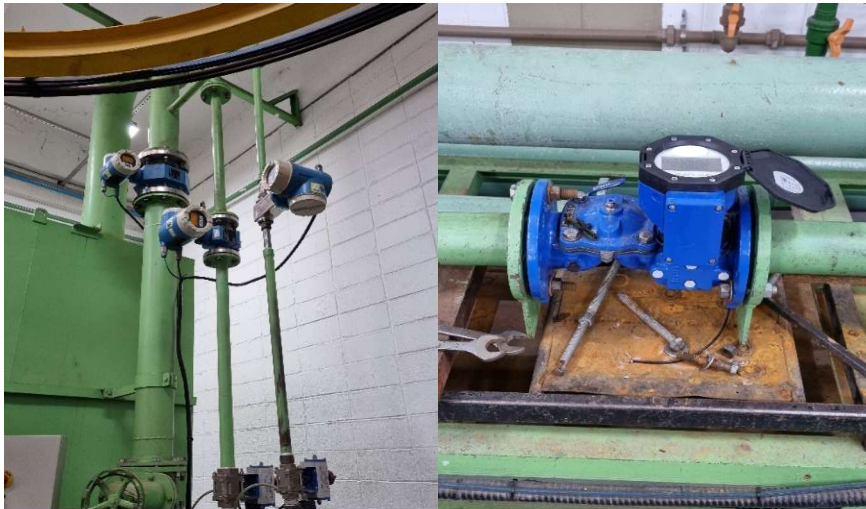
Figura 5 - Medidor eletromagnético e VRP com medidor instalada na rede de teste (Fonte: Autor)
