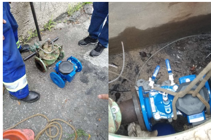
Figura 2 - Comparação entre os equipamentos e instalação da VRP com medidor integrado (Fonte: Autor)
