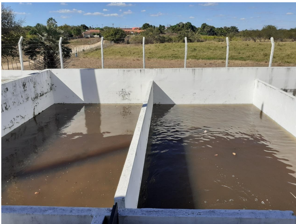
Figura 8 — Leitos drenantes funcionando por batelada.
