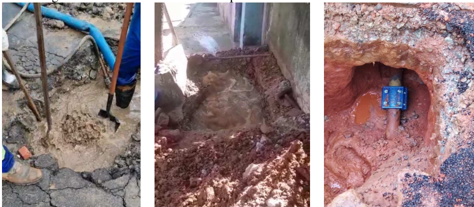
Figura 4 - Fotos de vazamentos e reparos realizados no setor Itaim Paulista.
