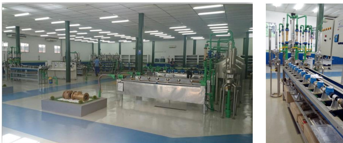
Figura 4: Instalações do Laboratório de Medidores da CEDAE-RJ e Bancada de Ensaio de IDM.
