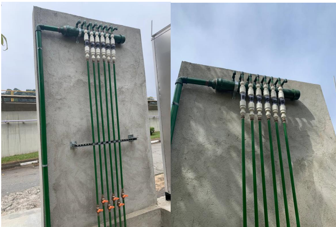
Figura 3 – Torre de equalização das amostras posicionadas na entrada do Shelter .
