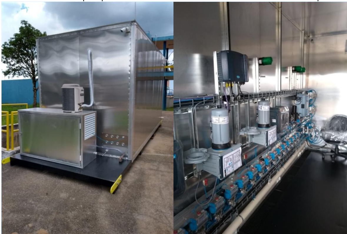
Figura 4 - Visão externa e interna do Shelter
