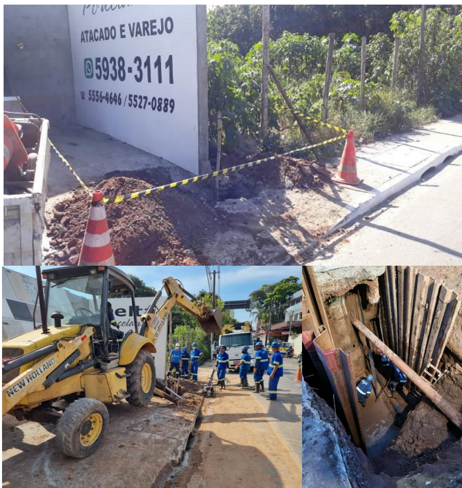
Figura 14 - Foto da localização do vazamento
