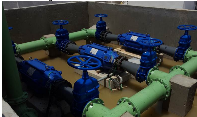
Figura 5 - Estação Elevatória de Água Bruta - EEAB
