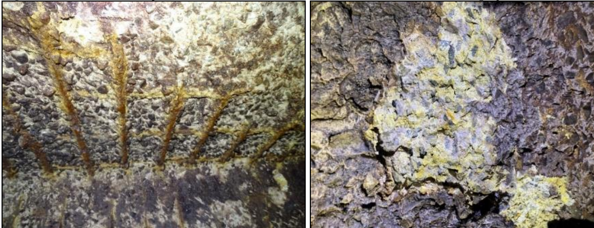
Figura 5 - (a) Barras de aço dissolvidas (b) manchas amareladas e camada esbranquiçada
