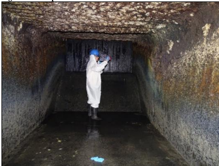
Figura 4 - Comporta de entrada do efluente
