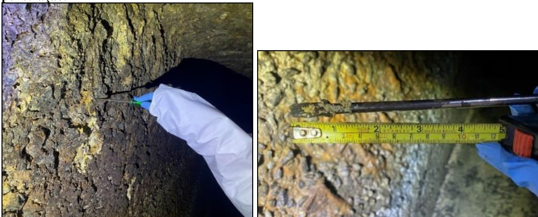
Figura 6 - (a) penetração da chave de fenda na superfície do concreto (b) medição da profundidade de penetração.
