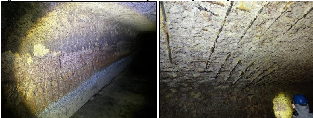
Figura 7 - (a) Dissolução das armaduras das paredes (b) aspecto da laje de cobertura
