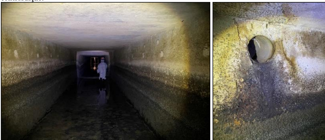
Figura 8 - (a) Trecho do canal menos degradado (b) aspecto do concreto próximo ao ponto de contribuição.
