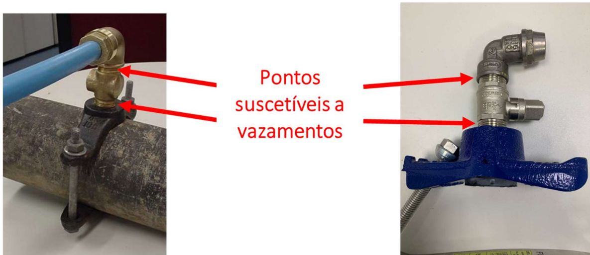
Figura 3 – Conjuntos montados com destaque para as juntas suscetíveis a vazamento.
