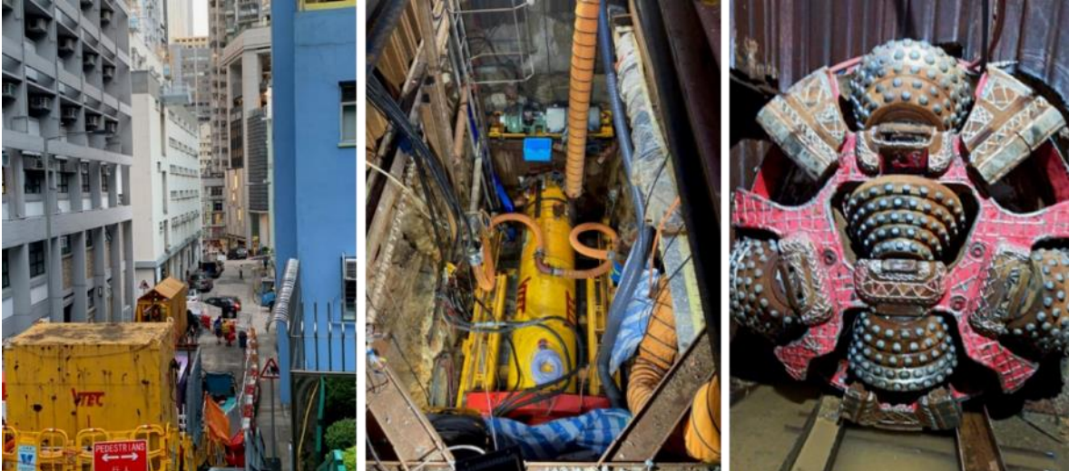
Figura 6 – Canteiro de obras, poço de emboque e AVN 800 HR após conclusão do trecho
