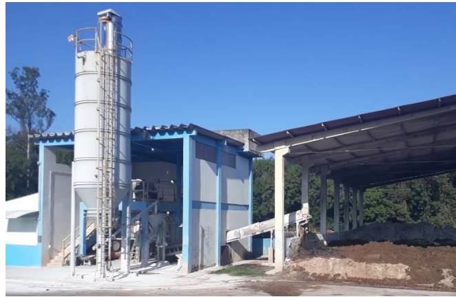
Figura 1 – Estrutura de mistura de cal ao lodo, Unidade de Gerenciamento de Lodo ETE Sul, Maringá Paraná
