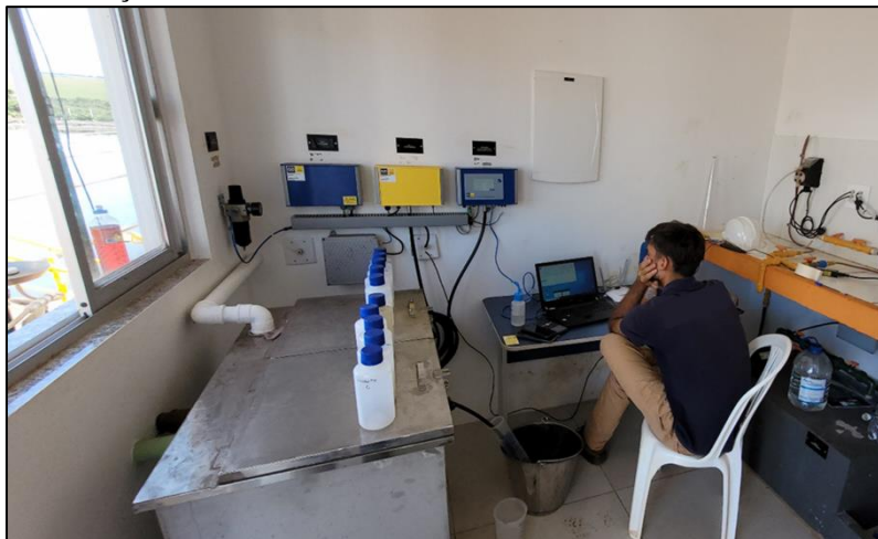
Figura 5 – Setup da instalação das sondas UV/Vis no Sistema 2 – ETE de GO
