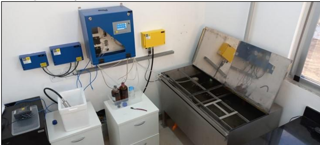
Figura 4 – Setup da instalação das sondas UV/Vis no Sistema 1 – ETE do RS
