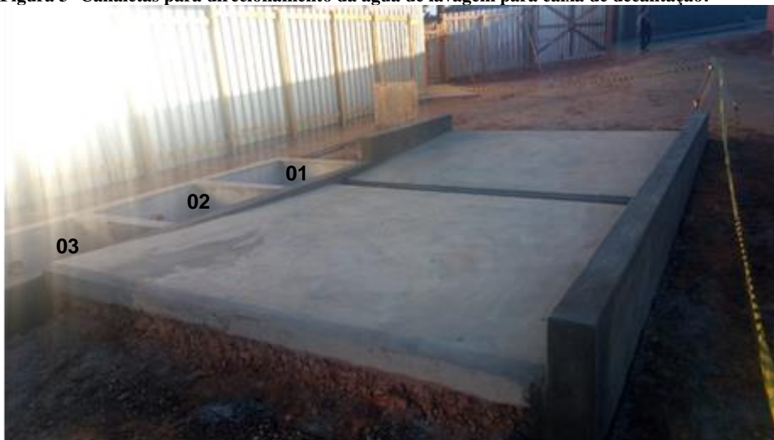
Figura 3- Canaletas para direcionamento da água de lavagem para caixa de decantação.
