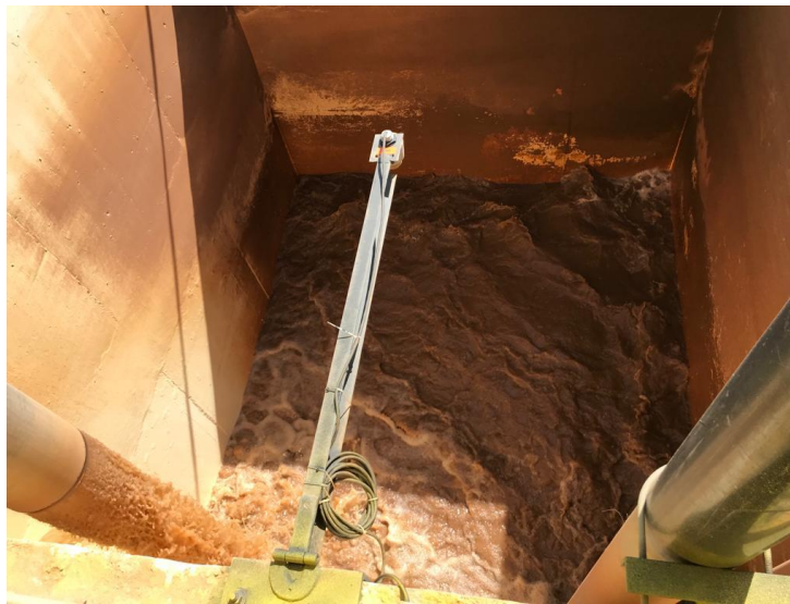
Figura 6. Tanque de recebimento de efluentes de retrolavagem sem químicos
