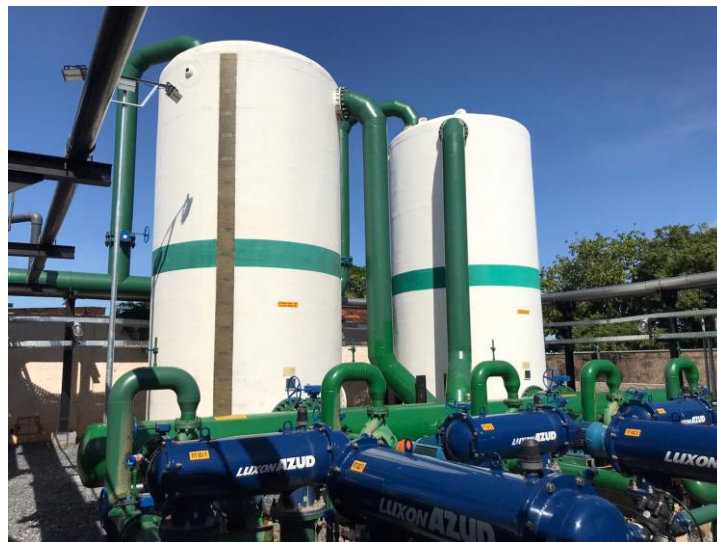
Figura 3. Tanques de água bruta
