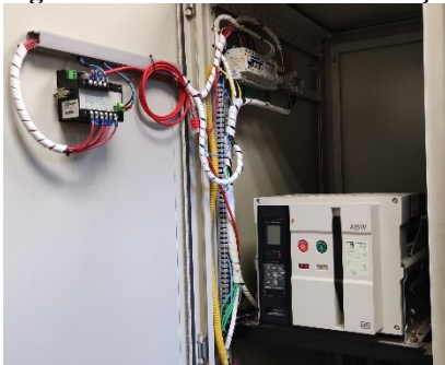
Figura III - Hardware de automação localizado no Bloco 1
