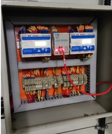
Figura II - Hardware de automação localizado na subestação Rua Mariz e Barros
