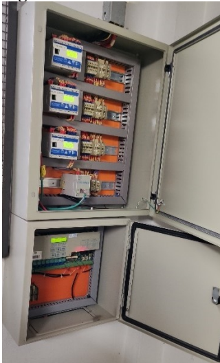
Figura IV - Hardware de automação localizado na subestação Rua Moraes e Silva
