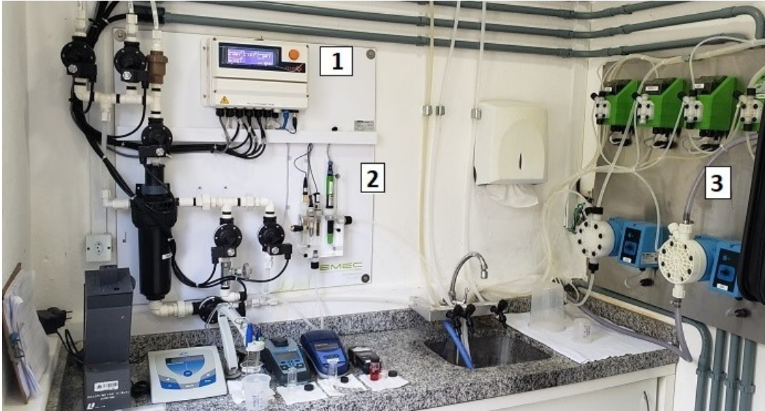
Figura 4- Vista geral dos analíticos e das bombas dosadoras. 1) analisador multiparâmetro de turbidez, pH, cloro e flúor. 2) sondas que realizam as análises. 3) Bombas dosadoras que ajustam a dosagem de acordo com as leituras.
