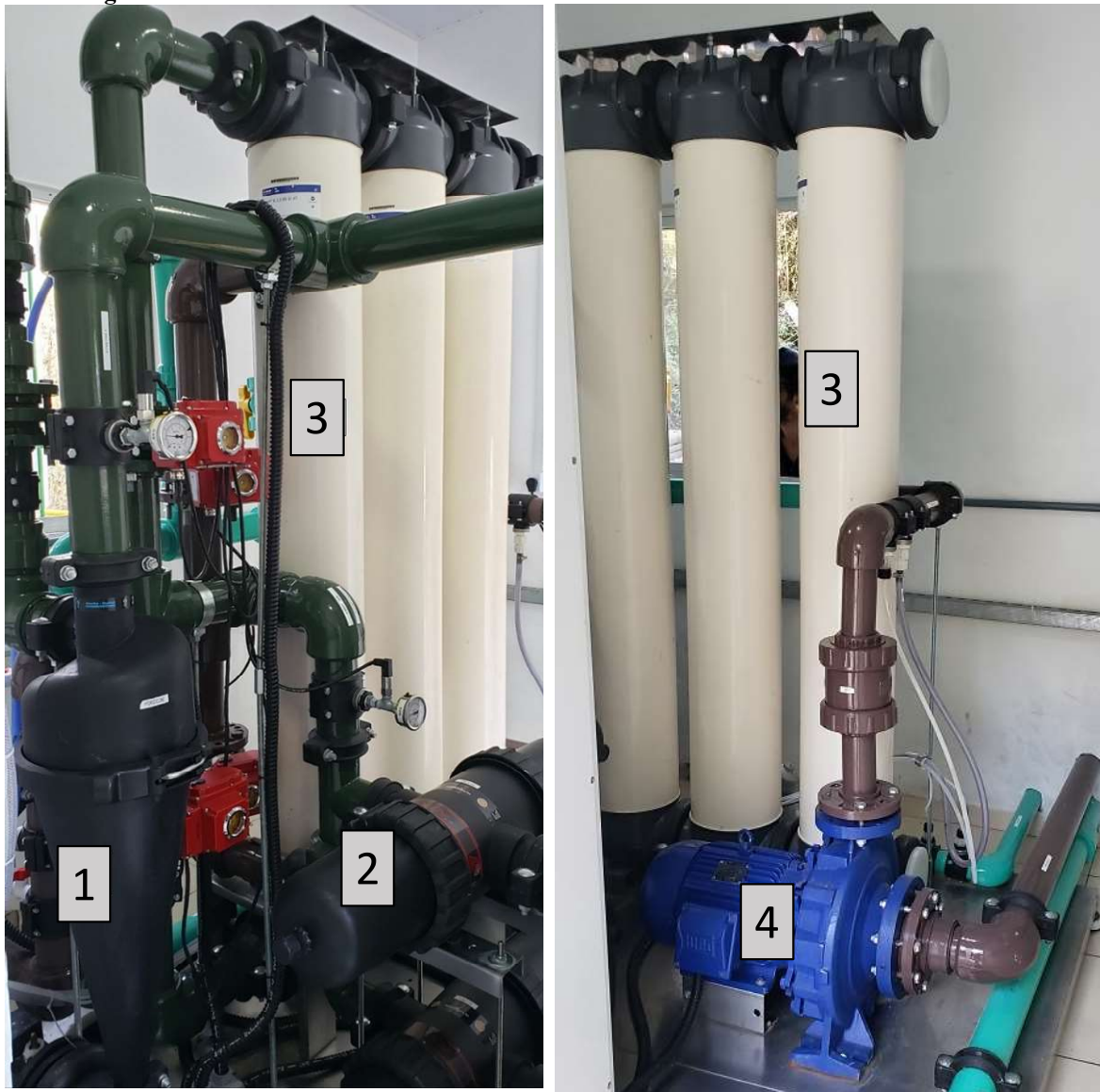
Figura 3- Vista geral da ETA UF. 1) hidrociclone para remoção de sólidos. 2) Filtro disco com abertura de 100 µm. 3) módulos de ultrafiltração, com área de 80m² cada. 4) Bomba para a realização das retrolavagens.
